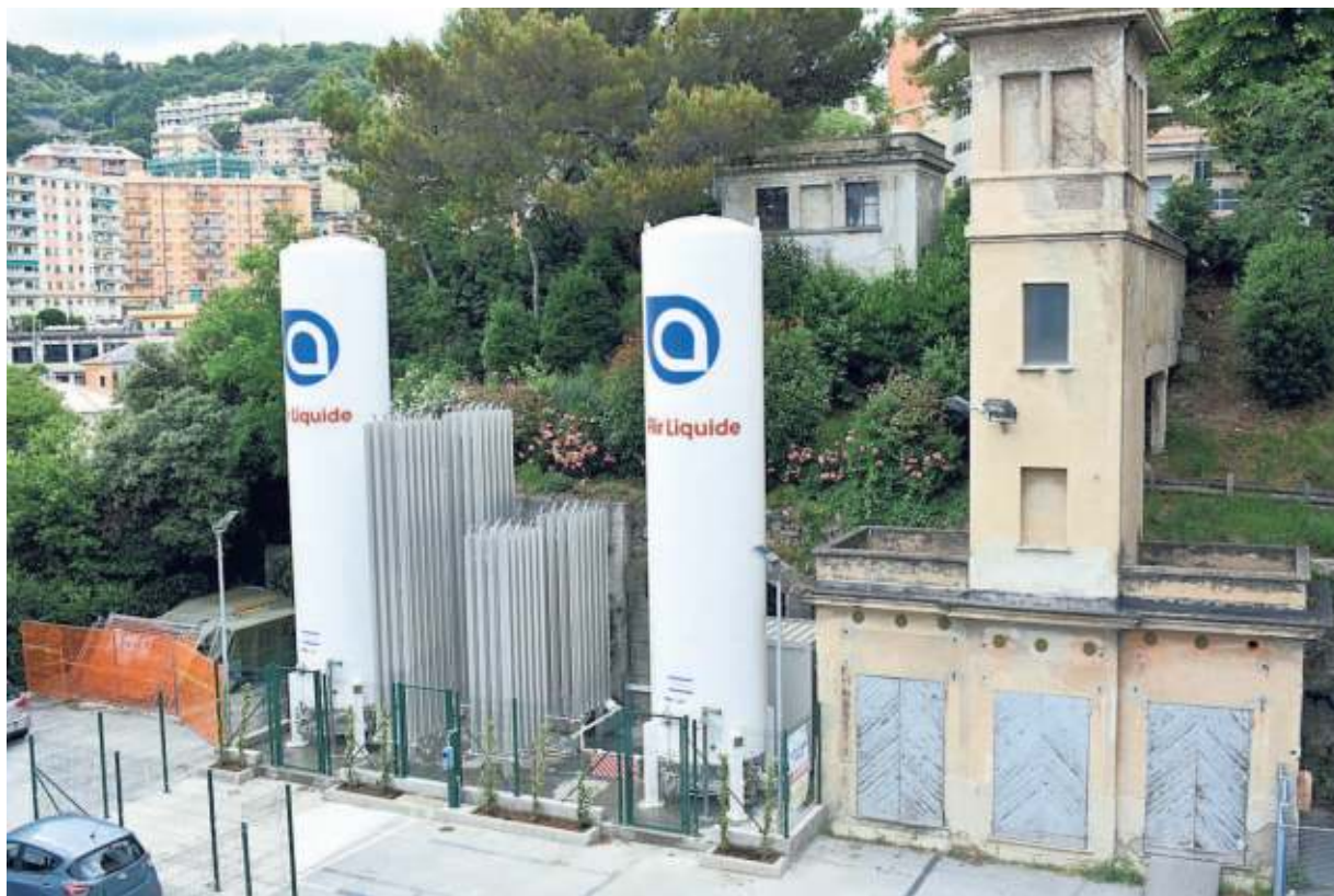
▲ Alle spalle del padiglione Cotella La nuova centrale che produce aria medica sintetica
