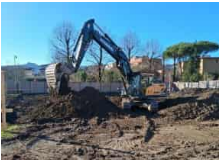
Avviati gli scavi per la realizzazione della nuova casa di comunità a Ceparana
