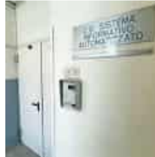
La sala dei server al Sant'Andrea
