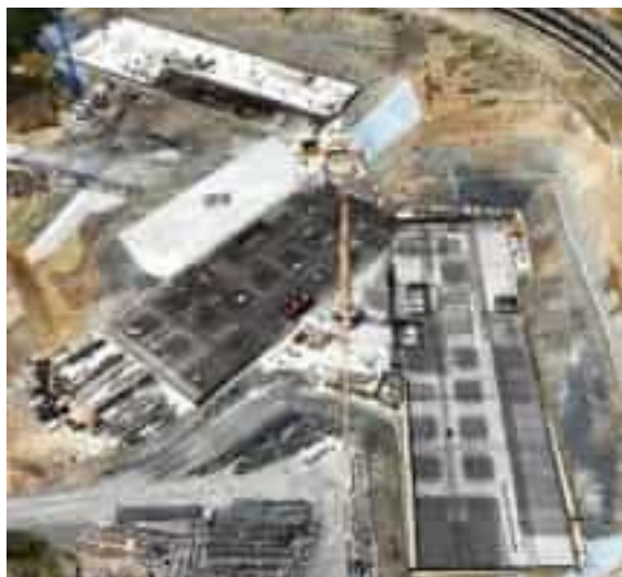
Una vista dall'alto del cantiere per la realizzazione del nuovo ospedale al Felettino. I lavori procedono spediti
